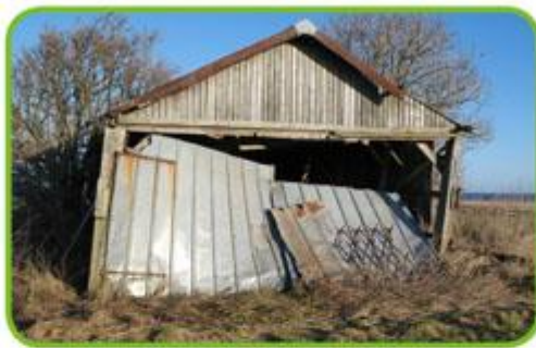
De to nederte markhuse bør sættes nedstrøftigt i stand
