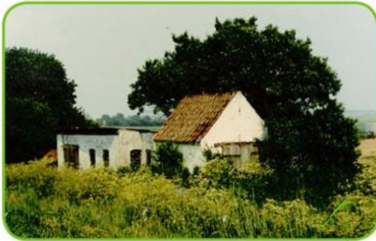
-Smedjen og sprøjtehuset trænger hårdt til en groopbygning
